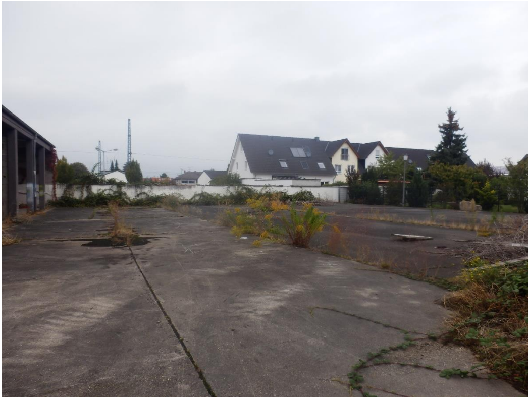
Bild 07: Der Hof des Busbetriebes mit ruderalem Aufwuchs in Schadstellen des Hofes
