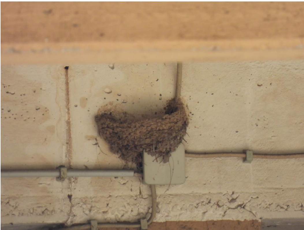
Bild 02: Blick auf eines der Nester
